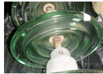
Figura 2. Isolador comum com corrosão.
