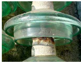
Figura 1. Isolador antipoluição com corrosão.
