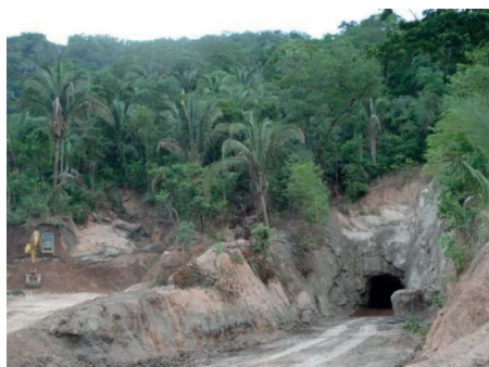
Fig. C8.4 Vista do emboque do túnel auxiliar e da encosta adjacente. A área em primeiro plano serviu de leito para a enxurrada causada pelo súbito esvaziamento do túnel de adução Fonte: Kanji (2017).
