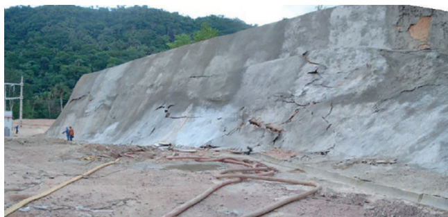
Fig. C8.12 Parede direita hidráulica da escavação na área de aproximação à casa de força. O concreto projetado foi trincado em inúmeros locais
