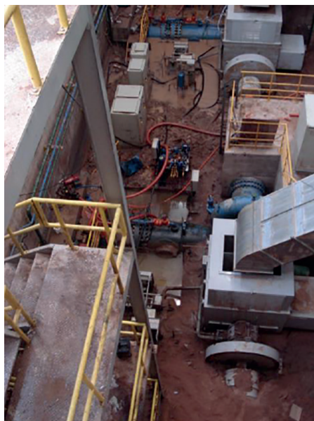
Fig. C8.5 Inundação da casa de força Fonte: Kanji (2017).
