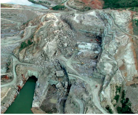
Fig. C4.13 Área de escavação do vertedouro e desemboque dos túneis de desvio 2 e 3 atingidos pelo escorregamento
