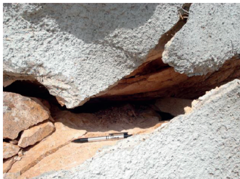
Fig. C8.13 Detalhe da abertura de trincas ao longo das paredes laterais, na área de aproximação à casa de força
