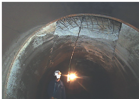
Fig. C10.4 Ruptura do revestimento de concreto projetado, expondo a tela metálica. Em primeiro plano, o conduto metálico
