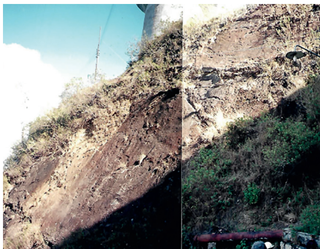
Fig. C5.9 Superfície de deslizamento coincidente com plano de falha geológica (foto de 1999)
