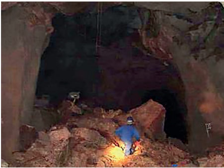
Fig. C8.8 Grande quantidade de blocos e fragmentos de rocha desprendidos das paredes e da abóbada do túnel de adução Fonte: Kanji (2017).
