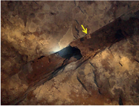
Fig. 2.7 Tratamento inadequado, na abóbada de um túnel hidráulico, evidenciado pela presença do chumbador em um dique de diabásio intemperizado
