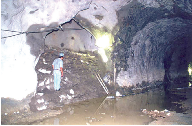
Fig. 6.1 Desmoronamento no túnel de desvio da UHE Queimado, com formação de cavidade de grandes dimensões Fonte: Assis (apud Seidenfuss, 2006).
