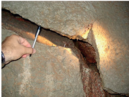
Fig. C8.9 Extensa fenda nas paredes do túnel de adução e do túnel auxiliar. Observar a abertura e o aspecto escalonado do plano de ruptura, mergulhando para jusante Fonte: Kanji (2017).
