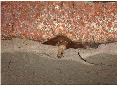
Fig. 2.10 Observação da parede de um túnel hidráulico acidentado para averiguar se o revestimento de concreto projetado foi aplicado conforme as determinações de projeto
