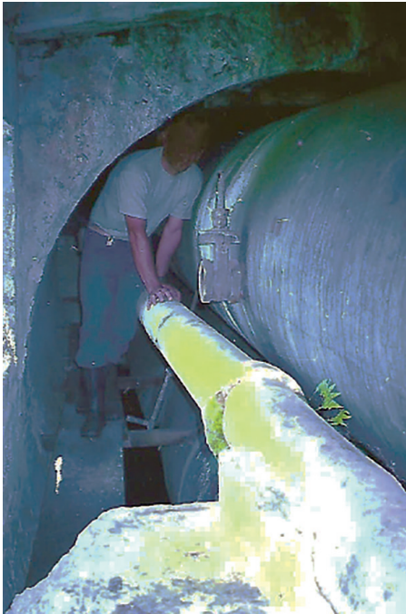
Fig. C5.12 Pouco espaço para manobra em razão da inserção dos dois tubos
