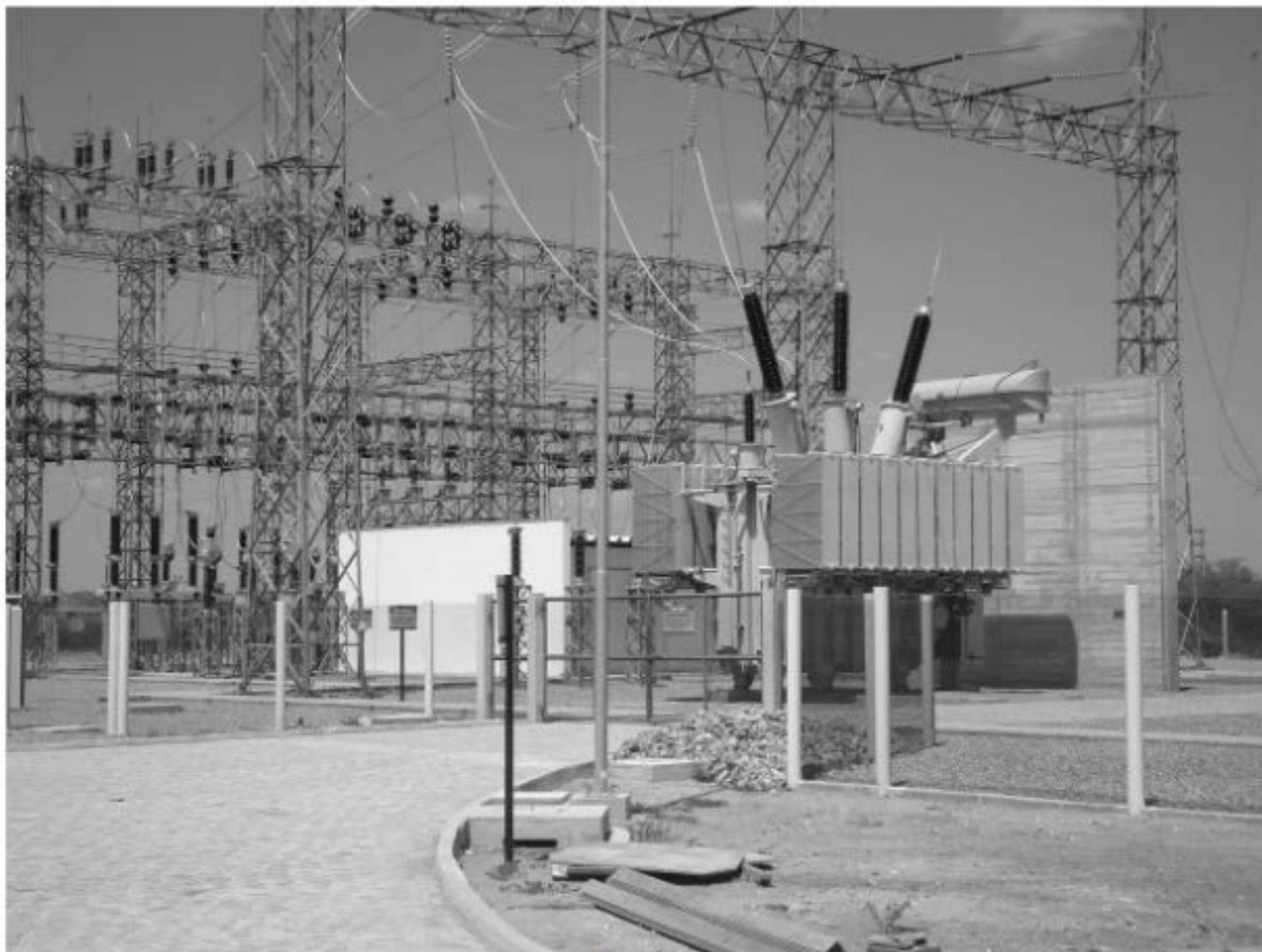
Figura 1.4 Subestação de 230 kV.
