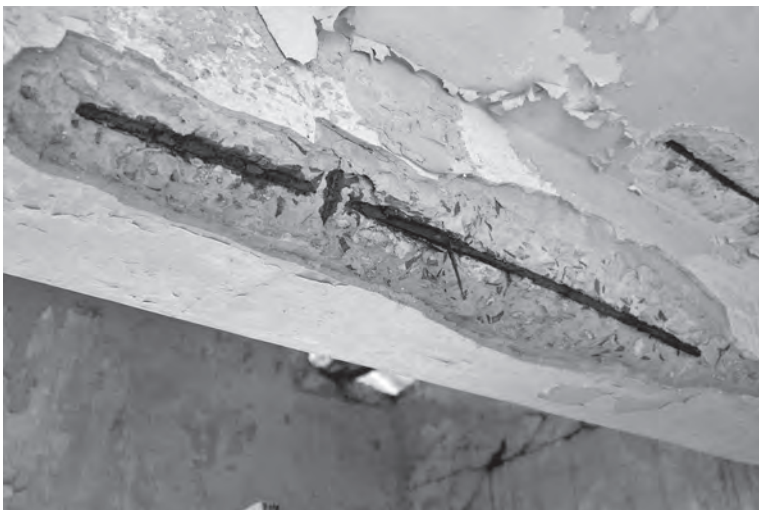
Fig. 2.27 Estado avançado de corrosão das armaduras da face inferior de uma viga na região metropolitana de Porto Alegre, Brasil
