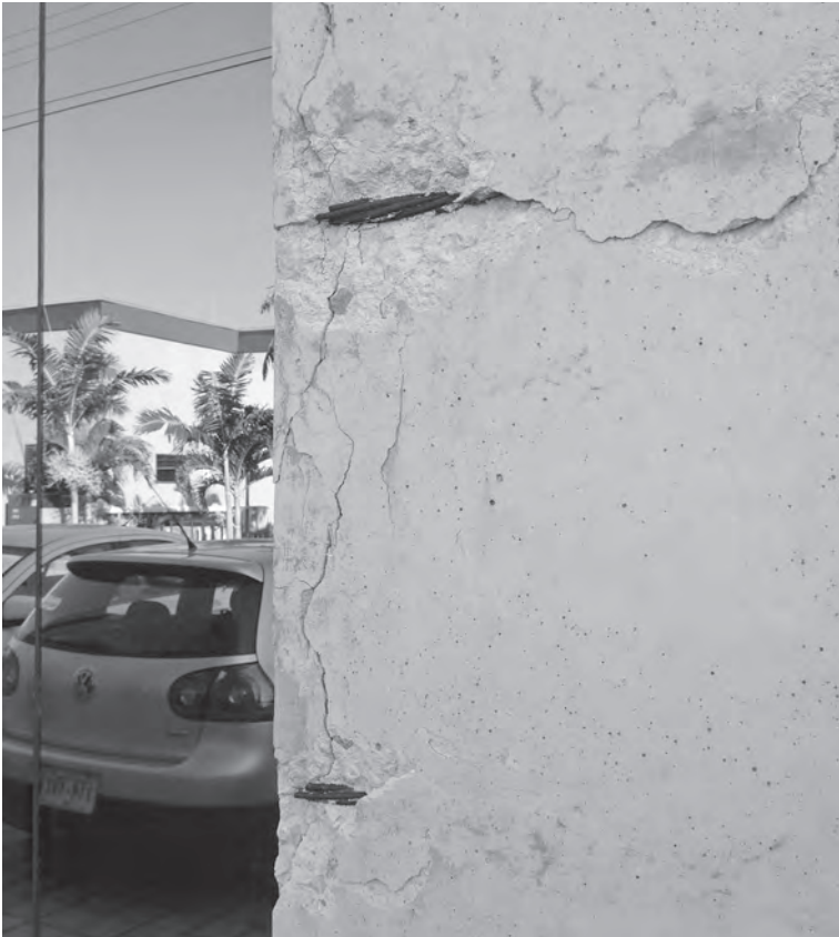
Fig. 2.26 Fissura e deslocamento do concreto na região dos estribos, junto à aresta de um pilar, na cidade de Mérida, México
