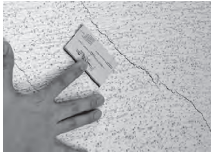
Fig. 1.16 Fissura em um sistema de revestimento em argamassa
