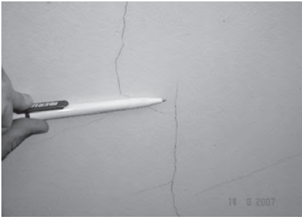
Fig. 1.15 Microfissura em um sistema de revestimento em argamassa
