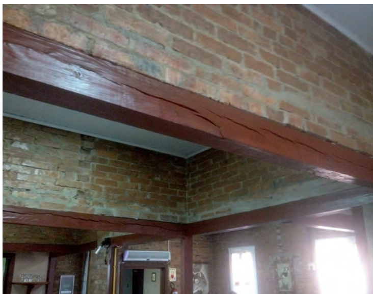
Fig. 4.22 Fissuras longitudinais no eixo da madeira, no sentido das fibras
