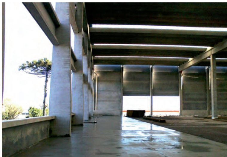
Fig. 2.14 Pilares com lixiviação curados com vapor quente em obra na cidade de Sapucaia do Sul (RS)
