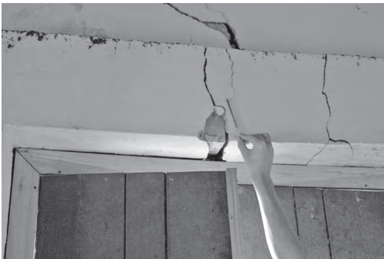
Fig. 1.19 Fissuras produzidas no sistema de vedação vertical de uma construção
