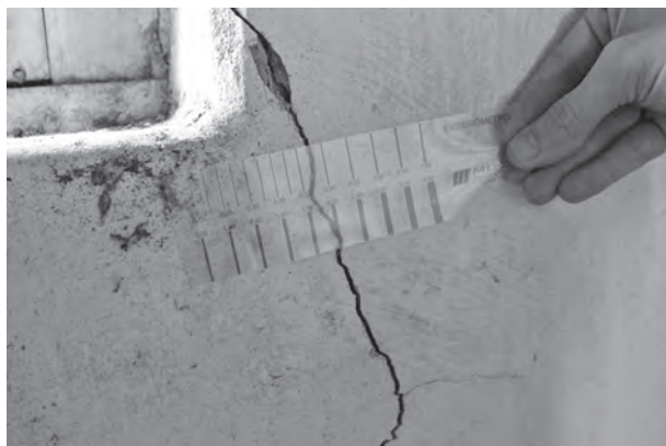
Fig. 2.94 Análise de fissura com fissurômetro
