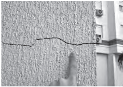
Fig. 1.17 Fissura ou trinca observada em um sistema de vedação vertical
