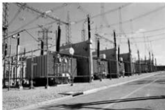
Figura 1.6 Subestação elevadora. (Cortesia de Furnas Centrais Elétricas.)
