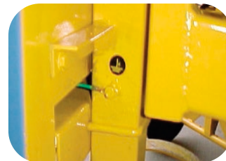
Ponto de aterramento existente na betoneira
