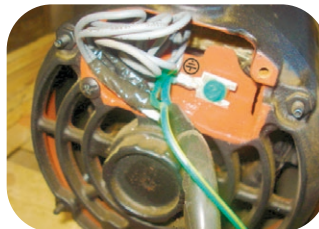
Ponto de aterramento existente no motor
